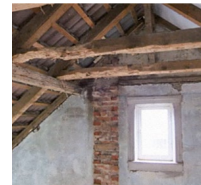
Abbildung 4 Nicht mehr tragfähige Kehlbalcken durch Schädlingsbefall
