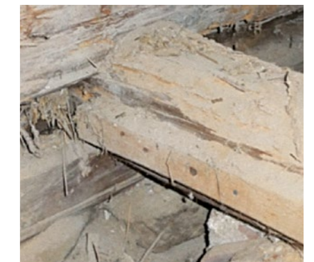
Abbildung 5 Problemstelle Auflagerbereich für Fußschwelle und Balkenköpfe
