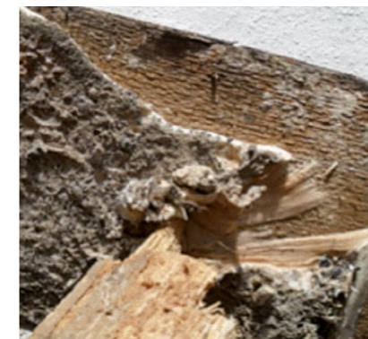
Abbildung 3 Pilzbefall unter Fußbodendielung
