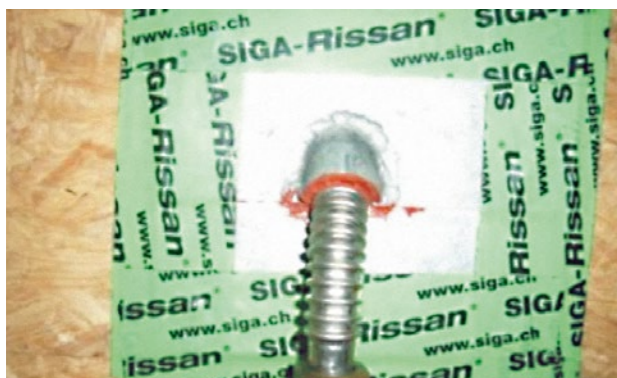
Abbildung 49 Rohrleitungsanschluss mit Anschlussplatte einer solarthermischen Anlage
