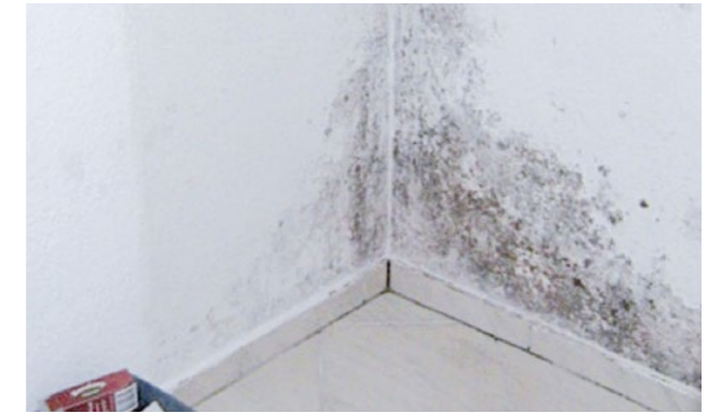
Abbildung 10 Schimmelenstehung in einer Rauminnen-ecke aufgrund unzureichender Oberflächentemperatur
