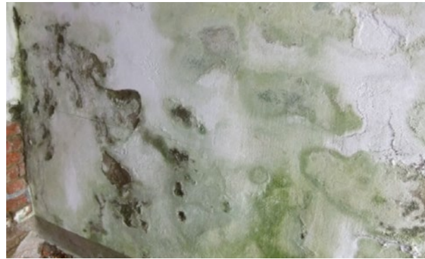
Abbildung 59 Extrem durchfeuchtetes Außenmauerwerk
