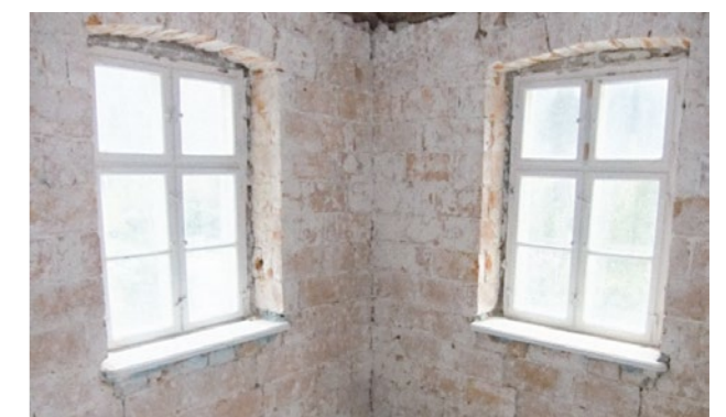
Abbildung 83 Fenster im Bestand mit Einfachverglasung
