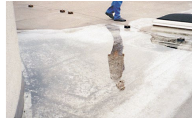
Abbildung 51 Pfützenbildung auf einem Flachdach – Schäden an der Dichtungsbahn sind die Folge
