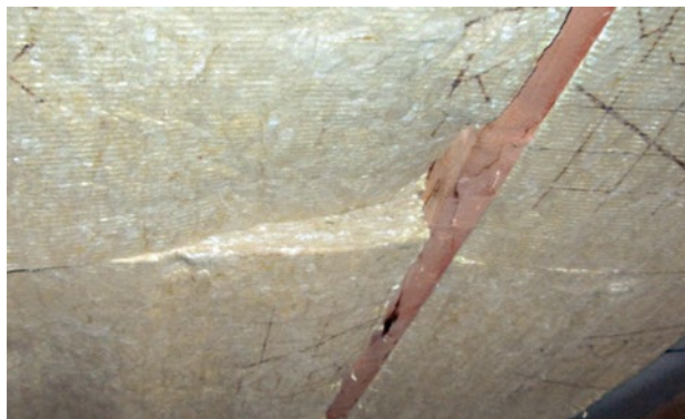
Abbildung 32 Zusammgedrückte Wärmedämmung zwischen den Sparren
